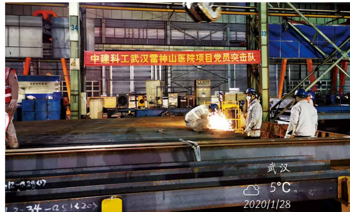
奋勇逆行，公司火速驰援武汉火神山、雷神山医院项目建设。
