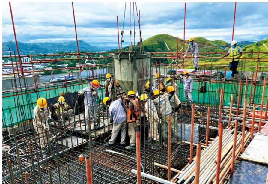
巴新星山广场二期项目核心筒15层底板浇筑 摄影：杜正扬 巴新星山广场二期项目
